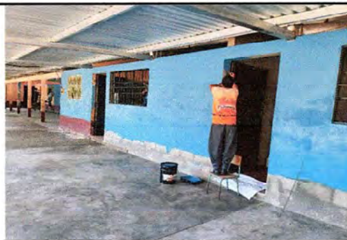
Foto 6: PINTADA DE MODULO 1 Y 2
